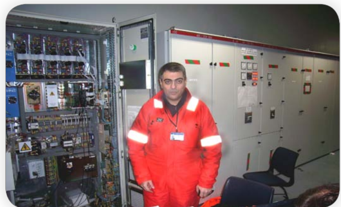
納入先の制御室
