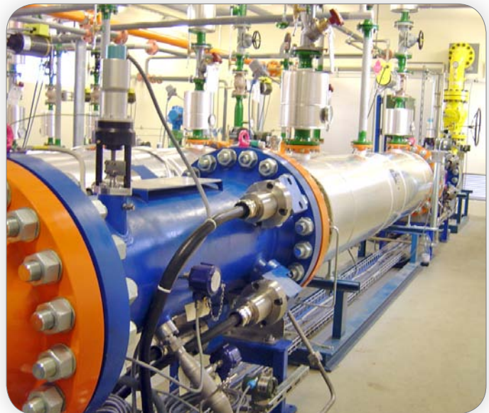
Gas Verbund Mittelland (GVM) 天然ガス膨張タービン発電システムは合計600kW(2台)の発電が可能
