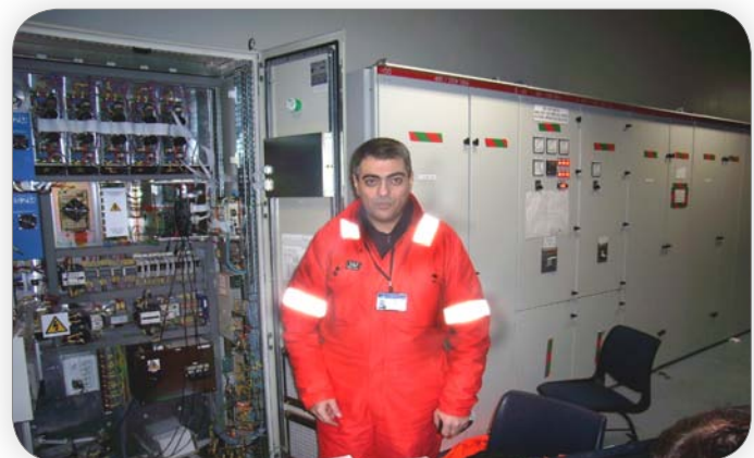
No local: na sala de controle
