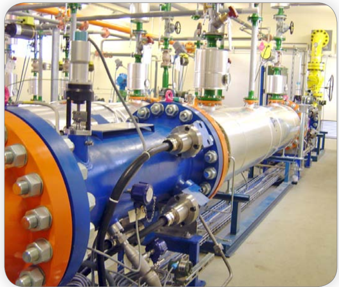
A Gas Verbund Mittelland (GVM), estação de recuperação de excesso de pressão de gás natural 600 kW (2 fases).
