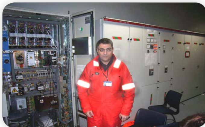
在现场：在控制间内
