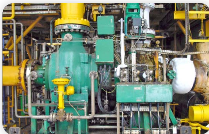
Пример агрегата GE Rotoflow, оснащенного подшипниками S2M, в эксплуатации с 1996 года на площадке Total N'Kossa (Африка)
